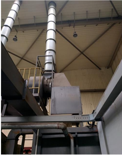
过滤棉加活性炭处理装置
